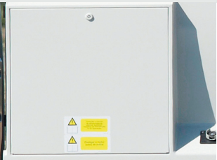
8 Cuadro eléctrico centralizado dentro de armario fácilmente accesible.
